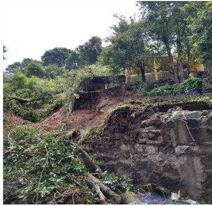
Imagen 38. Deslizamiento De Tierra Colonia Palma
