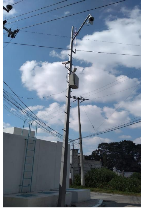
Imagen 145. Cámara colocada en la Col. Palma
