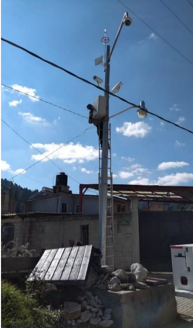
Imagen 140. Cámara colocada en la Col. Aurora
