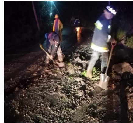
Imagen 37. Deslizamiento De Tierra Calle Cerezos
