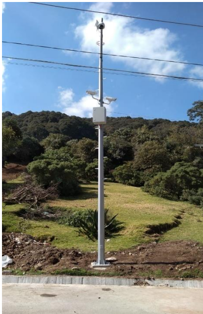
Imagen 142. Cámara colocada en la Col. Aurora
