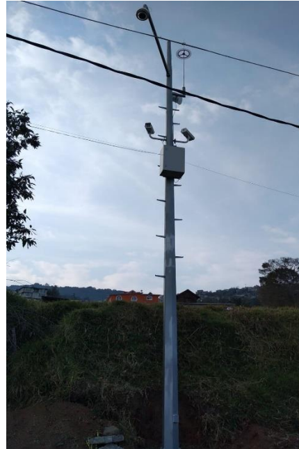
Imagen 141. Cámara colocada en la Col. Laureles
