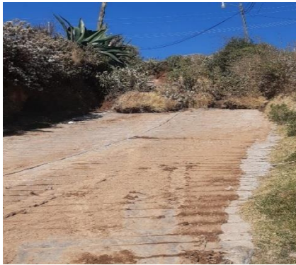
Imagen 36. Deslizamiento De Tierra Calle Cerezos
